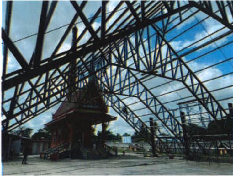
อุดหนุนวัดท่าบุญมี ตำบลท่าบุญมี อำเภอกะเจันทร์ โครงการก่อสร้างศาลาอเนกประสงค์ งบประมาณ 1,000,000 บาท โครงการอยู่ระหว่างดำเนินการ
